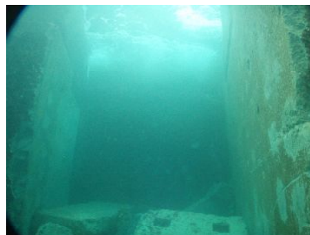
写真-2 被災状況 (北小浦漁港防波堤水中) (平成 20 年 2 月 27 日)
