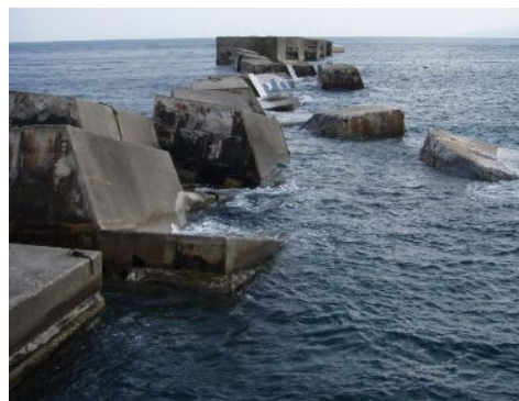
写真-1 被災状況 (北小浦漁港) (平成 20 年 2 月 27 日)
