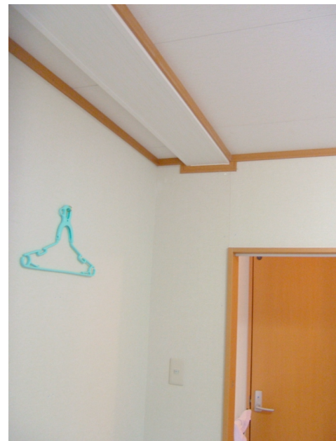
写真 7. S社の仮設住宅。上：中越地震の時は、室内の壁が鉄が剥き出しで熱橋となり、激しく結露して畳がかびた。下：能登半島地震の仮設住宅（志賀町鶴野屋）。ボードが貼ってあり結露しない。
