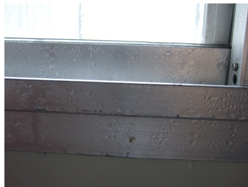
写真 14. 窓とサッシの結露
