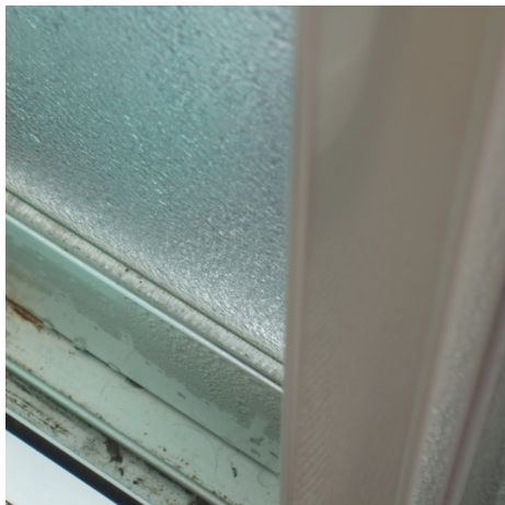
写真 6. 掃出し窓の結露。（輪島市山岸町仮設住宅）
