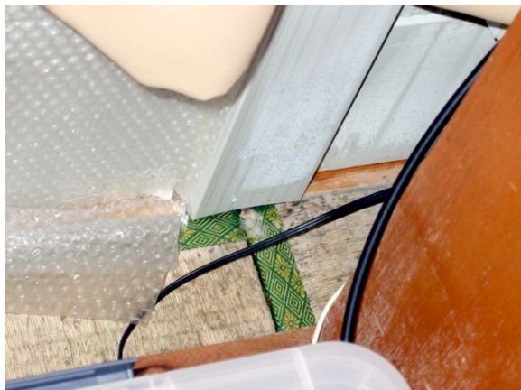
写真 16. 結露水による量のカビ（柏崎市西山町別山仮設住宅）
