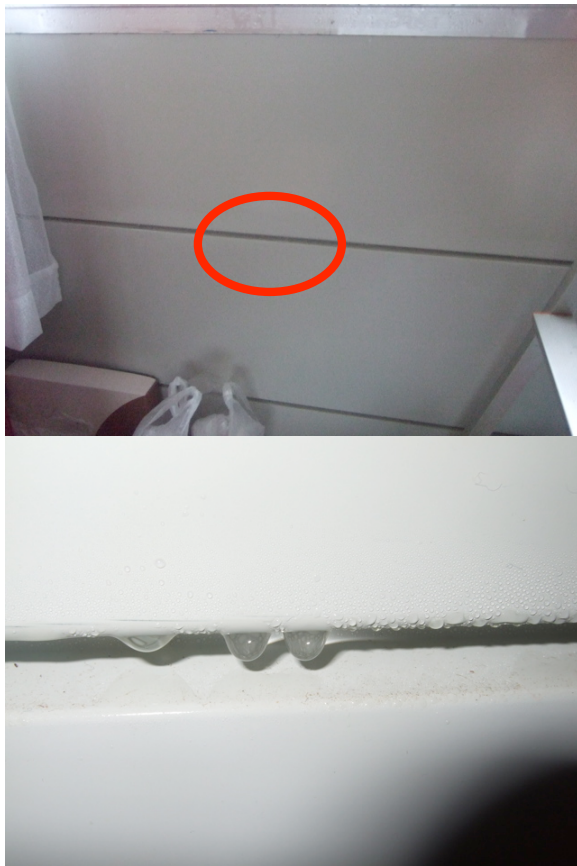
写真 15. D 社の壁（上）とその壁の溝に溜まった結露水（下：赤丸部分の拡大）（柏崎市西山町別山仮設住宅）
