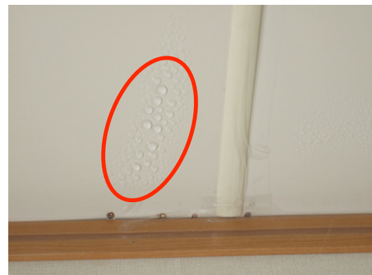
写真 18. 天井の結露（柏崎市西山町別山仮設住宅）
