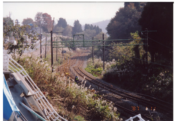
写真 16 地盤の沈下変位に伴う線路の変状
