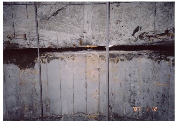
写真11 牛ヶ島トンネルの被害
