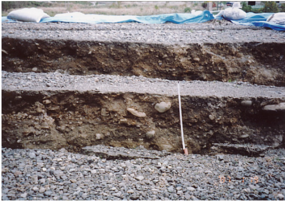
写真 14 浅河原調整池堰堤頂部にできた段差
