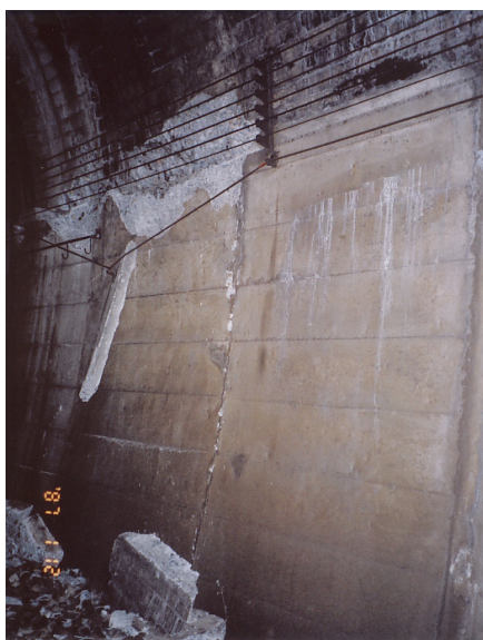
写真9 天王トンネルの被害
