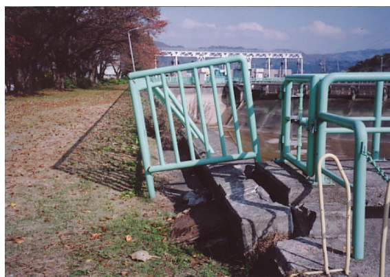
写真12 山本調整池取水設備の被害
