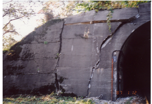
写真10 牛ヶ島トンネルの被害
