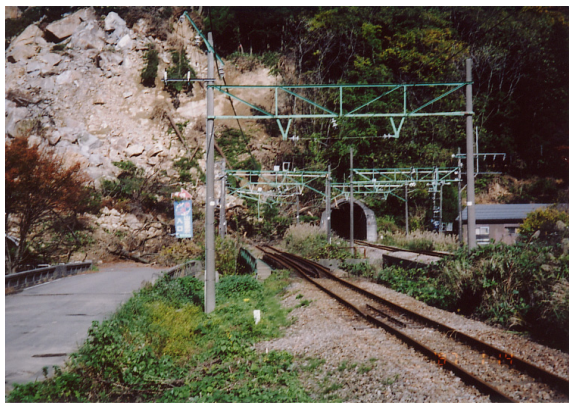
写真4 坑口を塞がれた榎木トンネル
