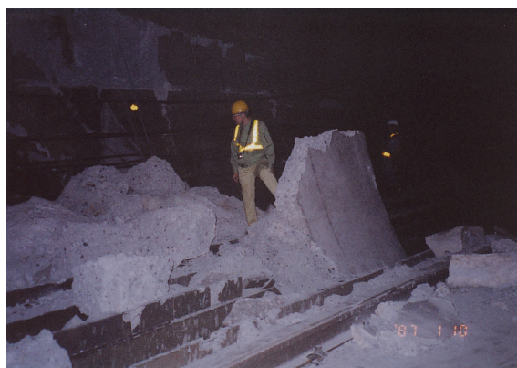
写真1 剥落した覆工コンクリート片
