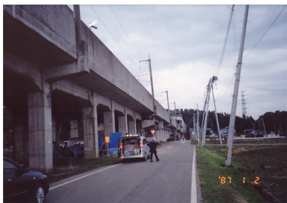
写真 20 脱線が始まったとされる地点から 滝谷トンネル方的高架橋
