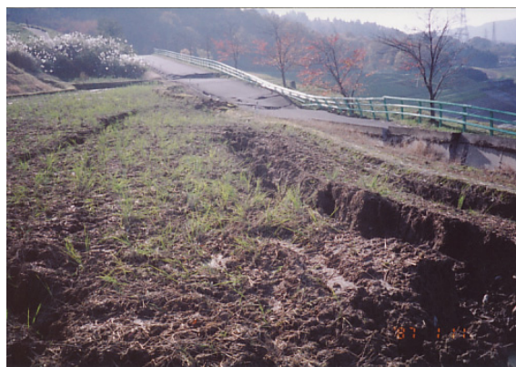
写真13 新山本調整池切り土斜面の被害
