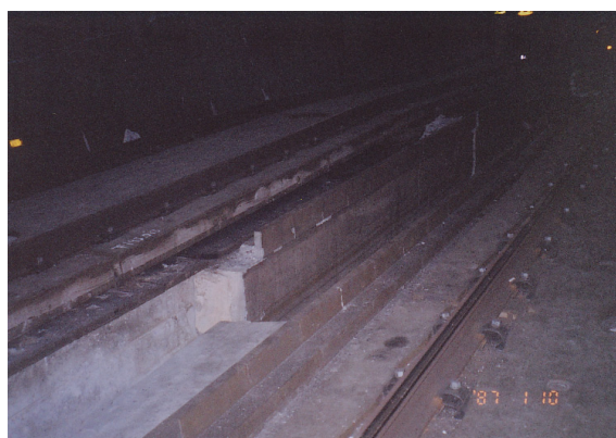
写真2 路盤コンクリート・軌道スラブの浮き上がり
