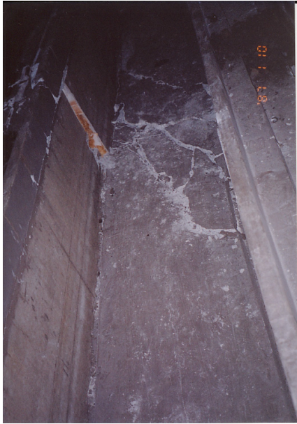
写真3 中央通路底面のひび割れ
