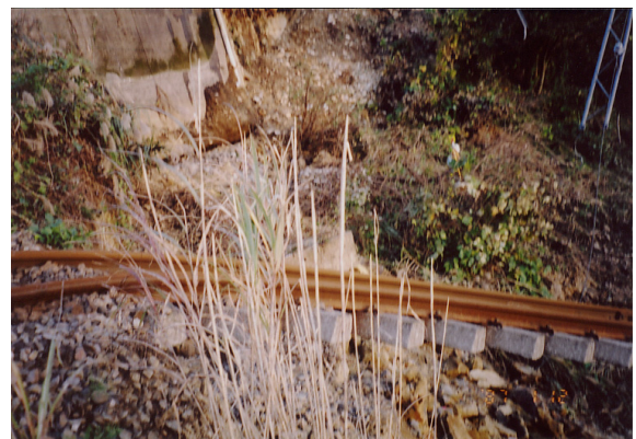
写真7 斜面崩壊により露出した天王トンネル
