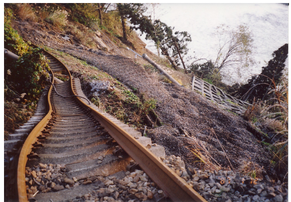
写真6 天王トンネル脇の斜面崩壊
