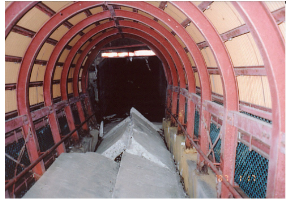
写真 15 竹田橋りょう取付け部の被害
