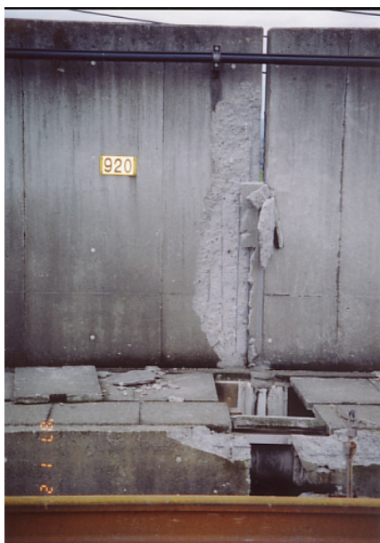
写真 18 高欄の衝突跡
