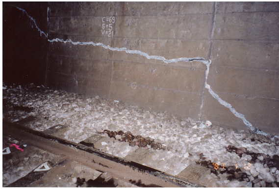
写真8 天王トンネルの被害
