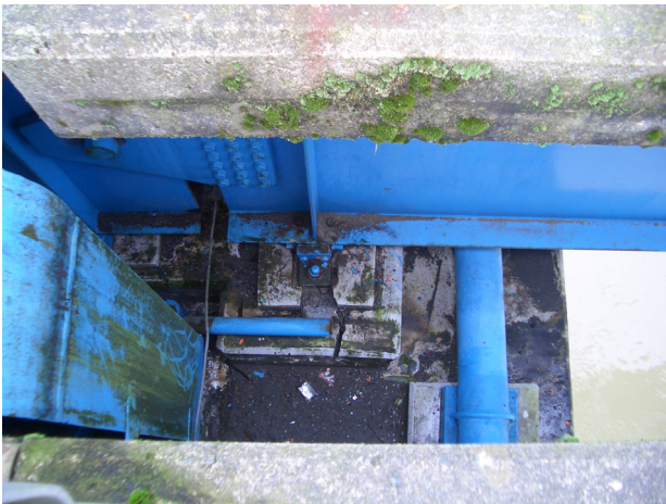
写真 25 沓座コンクリートの亀裂 (S7)
