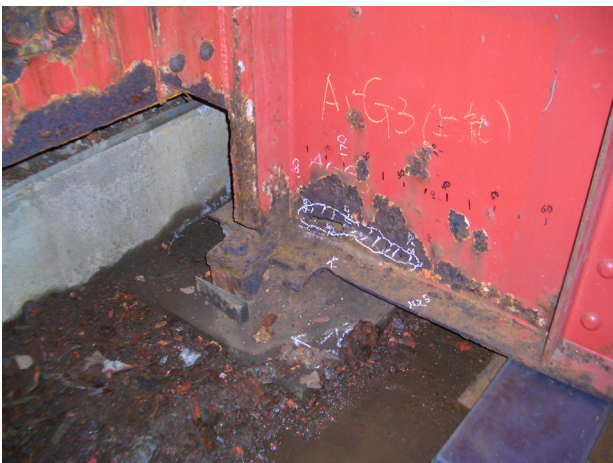
写真 19 腐食によるウェブ断面欠損 (S9)
