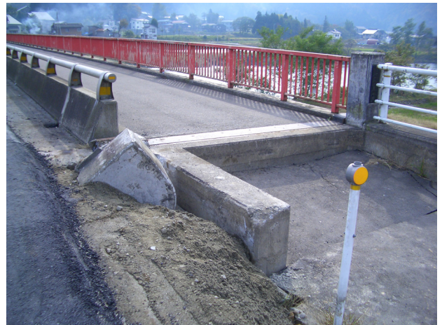
写真 16 橋台背面の陥没 (S9)
