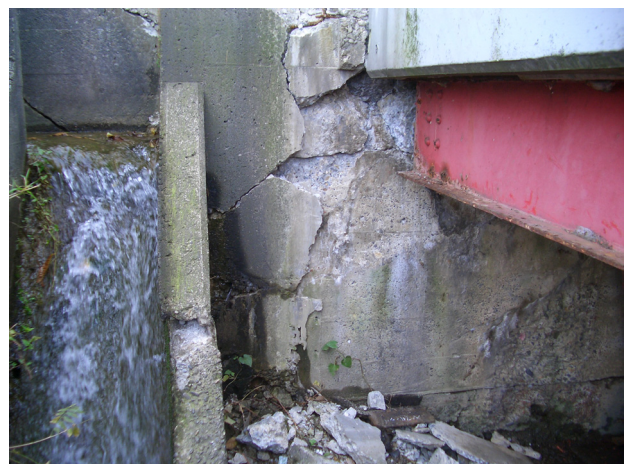
写真 17 桁衝突による橋台の破損 (S9)
