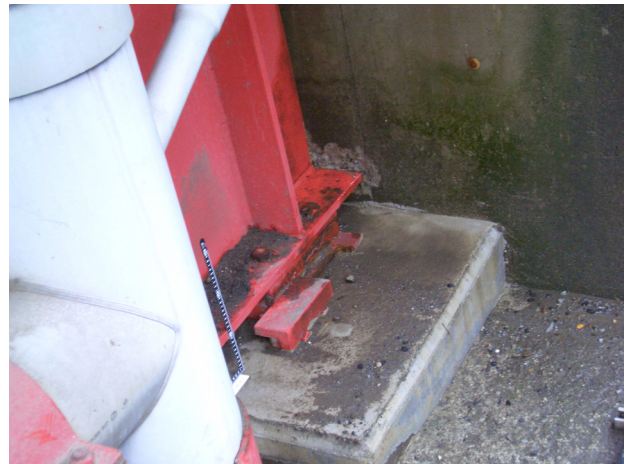
写真 10 桁と橋台の衝突 (S5)
