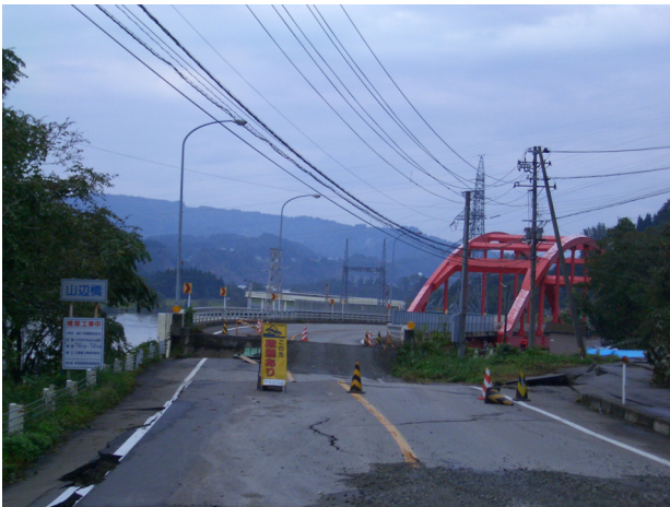
写真 7 橋台背面の陥没 (S5)
