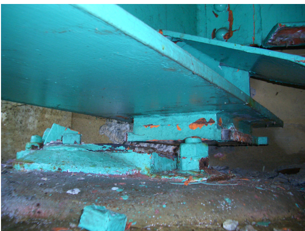
写真 2 支承の破壊 (S12)
