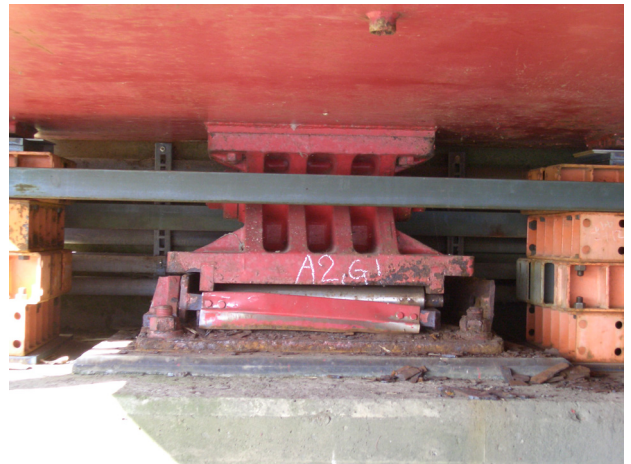
写真 28 支承部の破損 (S3)
