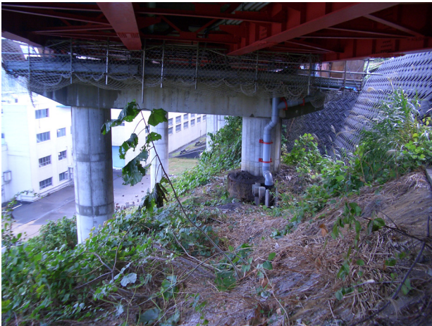
写真 6 斜面の陥没 (S5)
