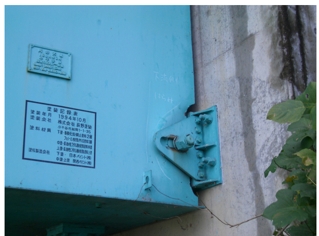
写真 23 落橋防止工とフェブの変形 (S6)
