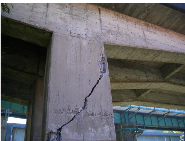
写真 20 橋脚の斜めひび割れ (C1)
