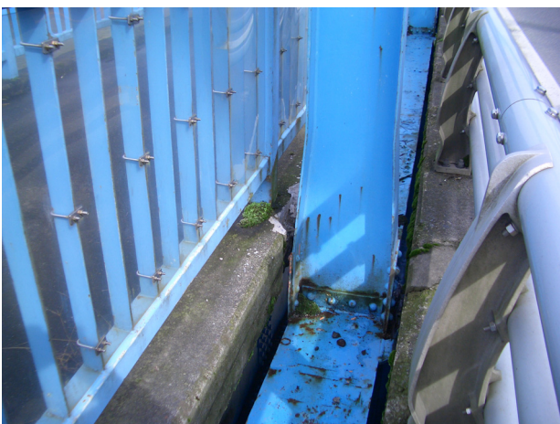
写真 26 側道橋床版とハンガーの衝突 (S7)
