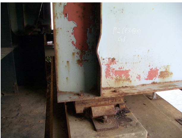
写真 14 I 桁垂直補剛材の座屈変形 (S2)
