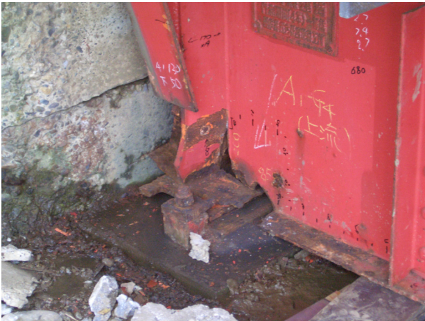
写真 18 桁端下部の破損 (S9)
