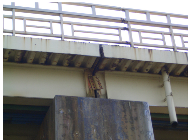
写真 29 桁連結版ボルトの破断 (S4)
