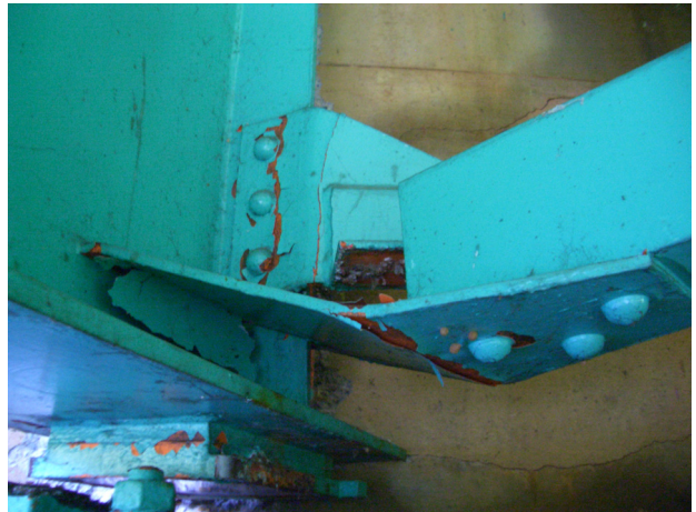
写真 3 端対傾構, 下横構の破損 (S12)
