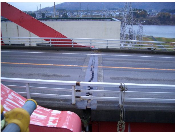
写真 8 伸縮継手の空き (S5)
