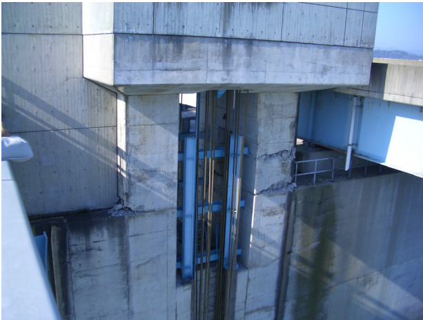
写真 12 堰の損傷状況 (S2)
