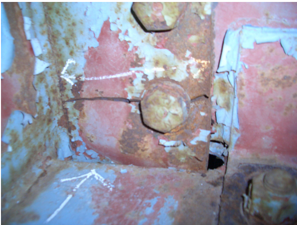
写真 13 I 桁垂直補剛材の破断 (S2)
