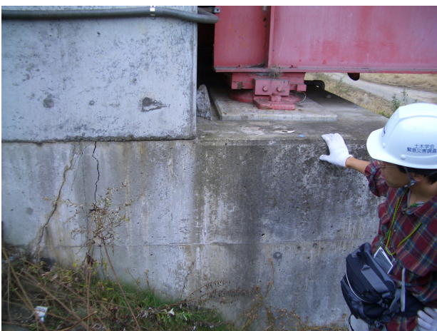
写真 32 橋台のひび割れ (S10)
