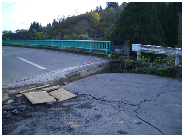
写真 5 橋台背面の陥没 (S12)
