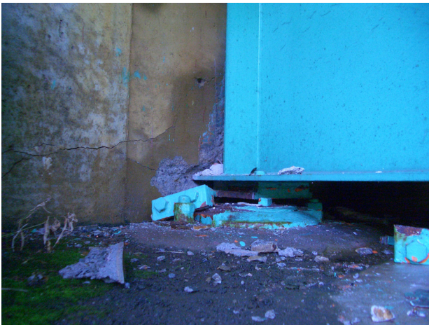
写真 1 支承の破壊 (S12)
