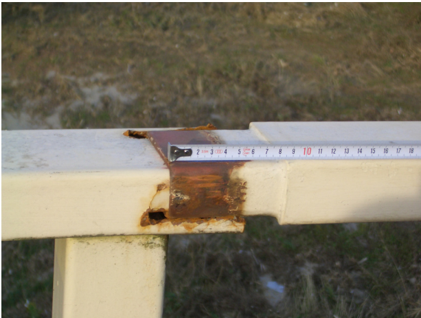
写真 30 高欄継手部のずれ (S4)
