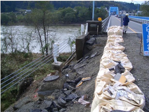
写真 24 取り付け盛土の流出 (S7)
