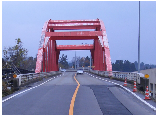
写真 9 橋梁のずれ (S5)
