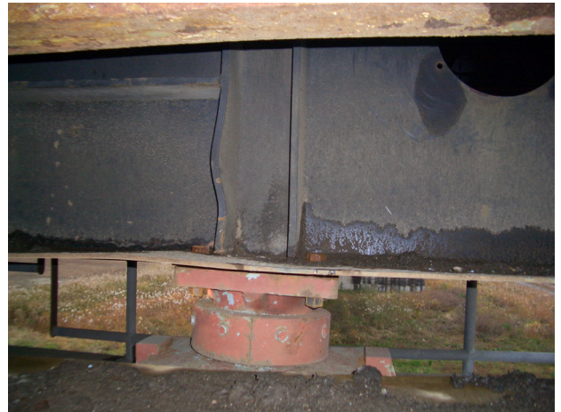
写真 15 箱桁ダイヤフラム垂直補剛材の変形 (S2)
