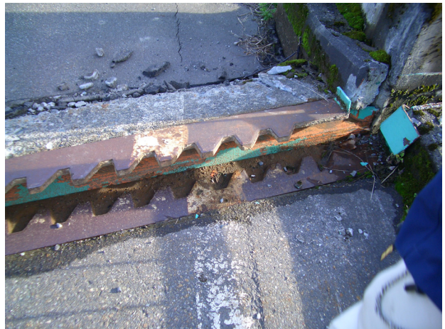
写真 4 橋台と上部工の衝突による伸縮継手の跳ね上がり (S12)
