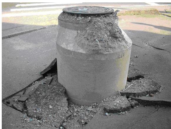
写真1 地震で飛び出したマンホール
