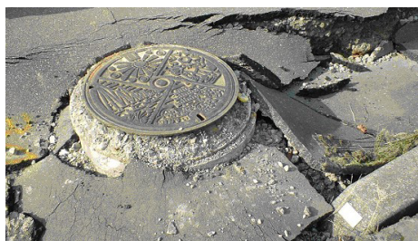
写真2 マンホール周辺の地盤沈下
