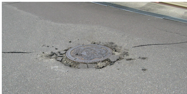
写真3 地盤とマンホールが別々に動いた
